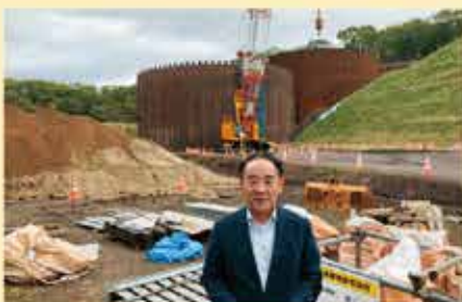
北海道胆振東部地震被災地 いまだ傷跡癒えぬが復旧作業が進む (元年10月7日 北海道勇威郡厚真町)
